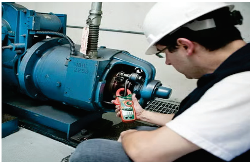
Рис. 3. Замір опору ізоляції двигуна
